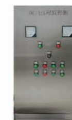
闸门远程控制柜
